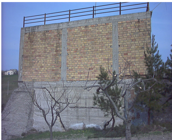
Fig. 17 Particolare area di San Bartolomeo interessata da diffusi fenomeni di dissesto dei fabbricati ( in corrispondenza del sondaggio S1)
